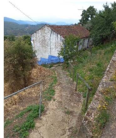
Figura 3 - Habitação insalubre com problemas de acessibilidade
