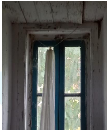
Figura 2 - Teto com fissuras e caixilharia degradada
